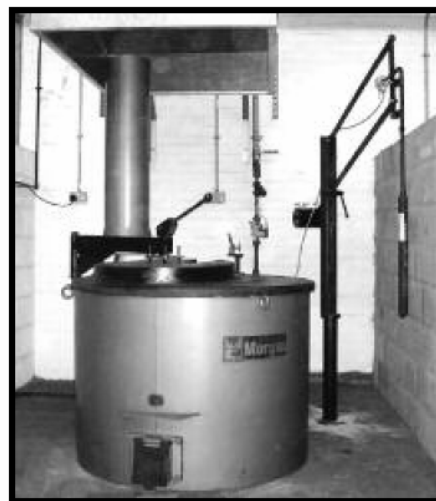
Fig.21 - Pirómetro montado en estructura marca Morgan, posicionado fuera del crisol.
